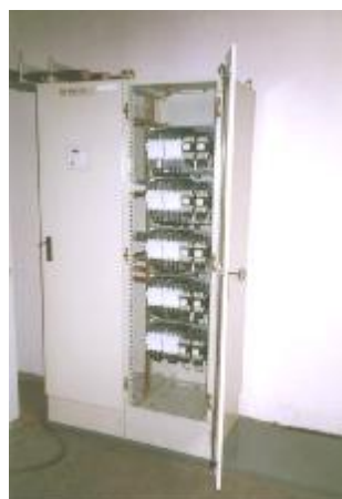
. . . a nový modulový rozváděč.
