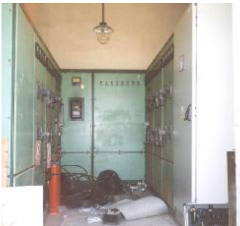
Rozvodna NN před rekonstrukcí ...
